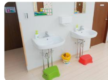
多目的洗面台
